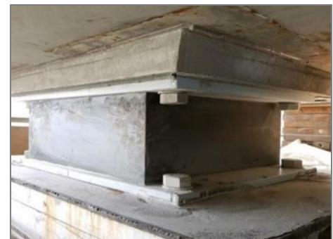
LRB Terpasang pada Struktur Jembatan
